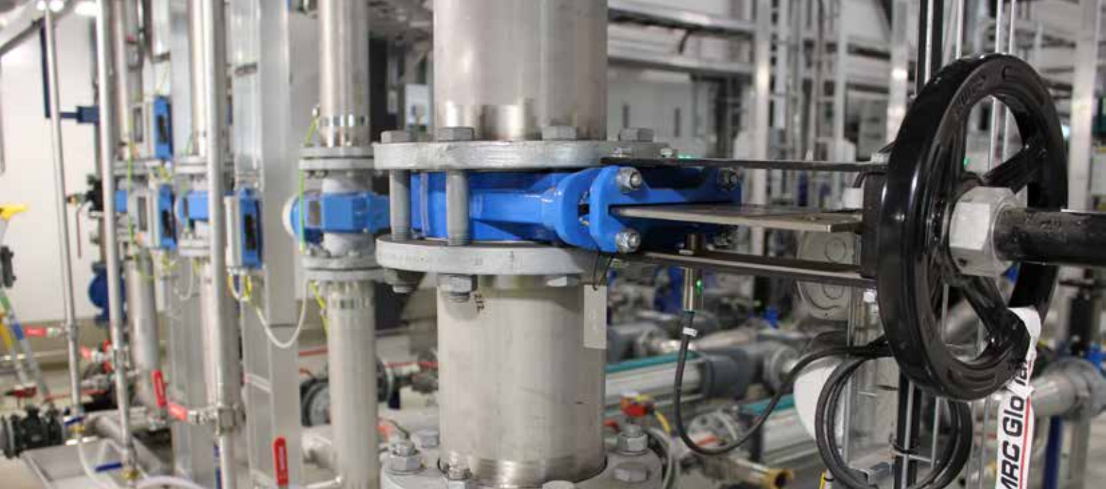
Uuden raakalietteen käsittelyrakennuksen prosessitekniikkaa
