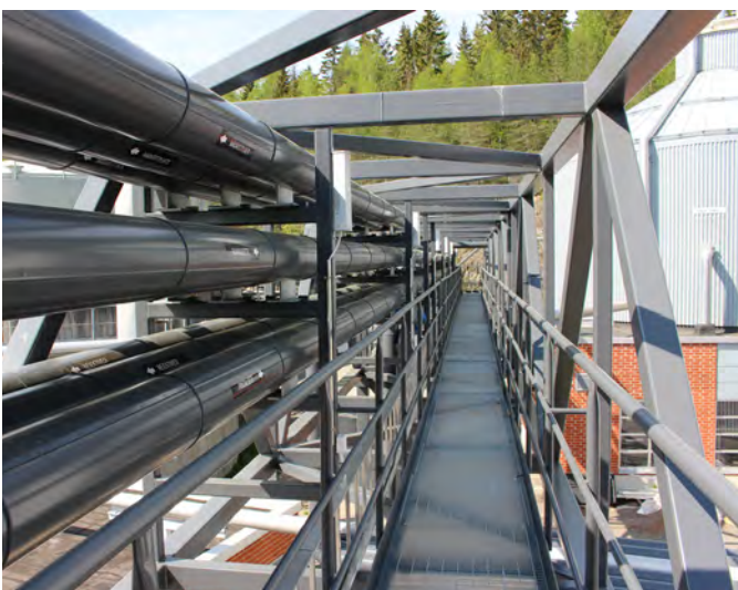
< JSPBio+ uusi putkisilta
