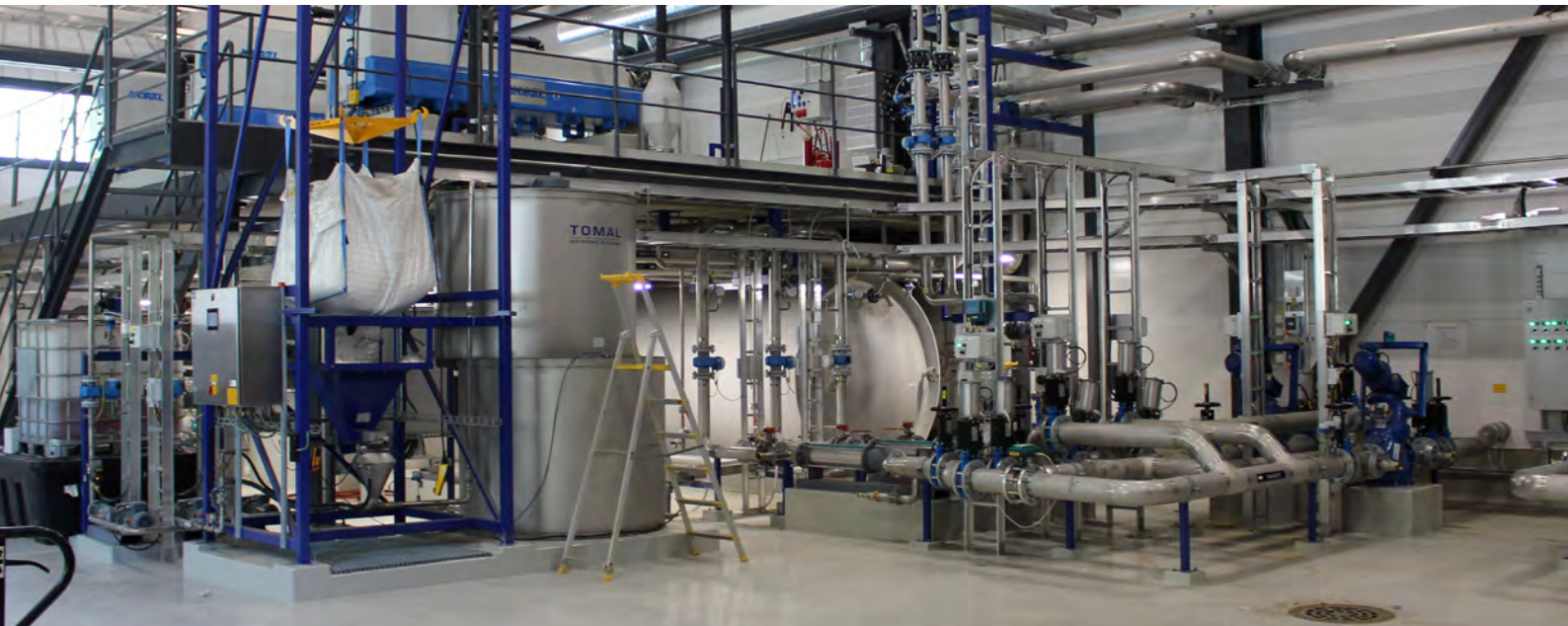
Sisä näkymä uudesta raakalietteen käsittelyrakennuksesta
