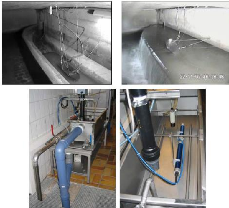
Kuva 2.3 UV-spektrometri asennettuna viemärikanavaan kelluvan ponttonin alapinnalle (ylemmät kaksi kuvaa) ja ohivirtauskanavaan (alemmat kaksi kuvaa) (Gruber et al. 2006)
